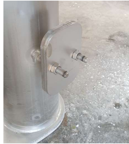
Abb 12: Connexion à la terre de la torche à gaz
