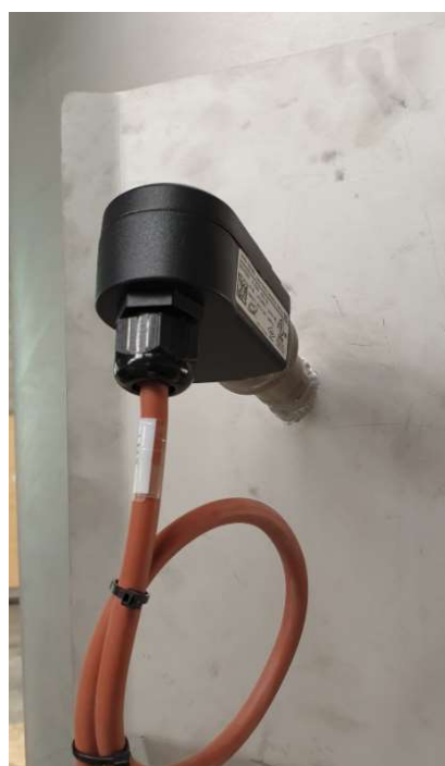
Fig. 8: cellule UV latéral sur la chambre de combustion avec chaleur
